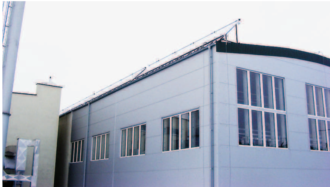
Baterie kolektorów na dachu hali fot. A. Taraszkiewicz
